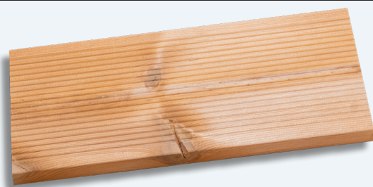
Kantenäste mit Rissen
