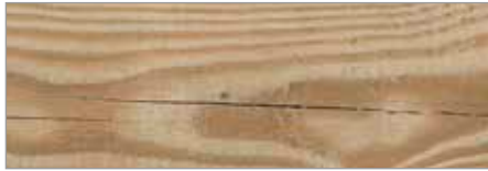
Trocknungsrisse (nach DIN zulässig)
