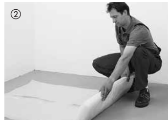
2 Grundsätzlich ist bei allen Estrichen und bei Verlegung auf Fußbodenheizung eine 0,2 mm starke PE-Folie auszulegen. Diese soll im Stoßbereich 30 cm überlappen. Anschließend die Folie im Wandbereich hochziehen und nach der Sockelleistenmontage an der Oberkante abtrennen.
