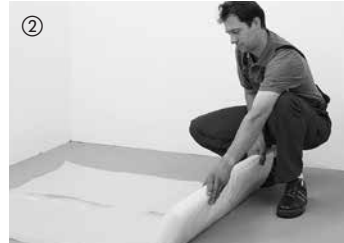
Grundsätzlich ist bei allen Estrichen und bei Verlegung auf Fußbodenheizung eine 0,2 mm starke PE-Folie auszulegen. Diese soll im Stoßbereich 30 cm überlappen. Anschließend die Folie im Wandbereich hochziehen und nach der Sockelleistenmontage an der Oberkante abtrennen.
