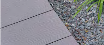
nach Reinigung mit Wasser
