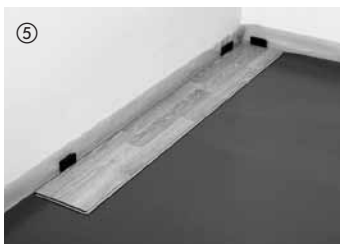
In der rechten Raumecke beginnend, werden die Elemente mit der Federseite zur Wand verlegt und mit Abstandskeilen fixiert (Dehnungsabstand zur Wand 10–15 mm).
